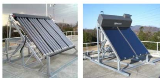
太陽熱給湯機（左：強制循環式、右：自然循環）
