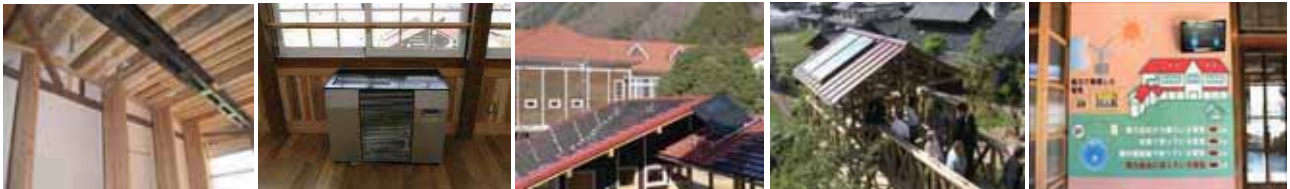
木造校舎耐震改修 ベレットストーブ 太陽光発電・風力発電 エコデッキと太陽熱パネル 発電量・消費量表示 環境省「学校エコ改修と環境教育推進事業」採択、愛媛県内最古の築77年の木造小学校の耐震・エコ改修（2010年2月末改修完了） 床面積2740㎡ 資料提供：M小学校エコ改修事務局+上野 貴建築研究所
