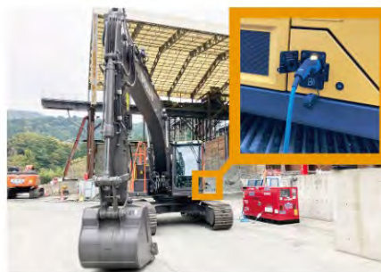
B100燃料専用発電機を用いた充電状況
